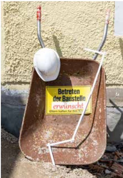
Am „Tag der Städtebauförderung“ konnten interessierte Bürgerinnen und Bürger die Baustelle besichtigen.
